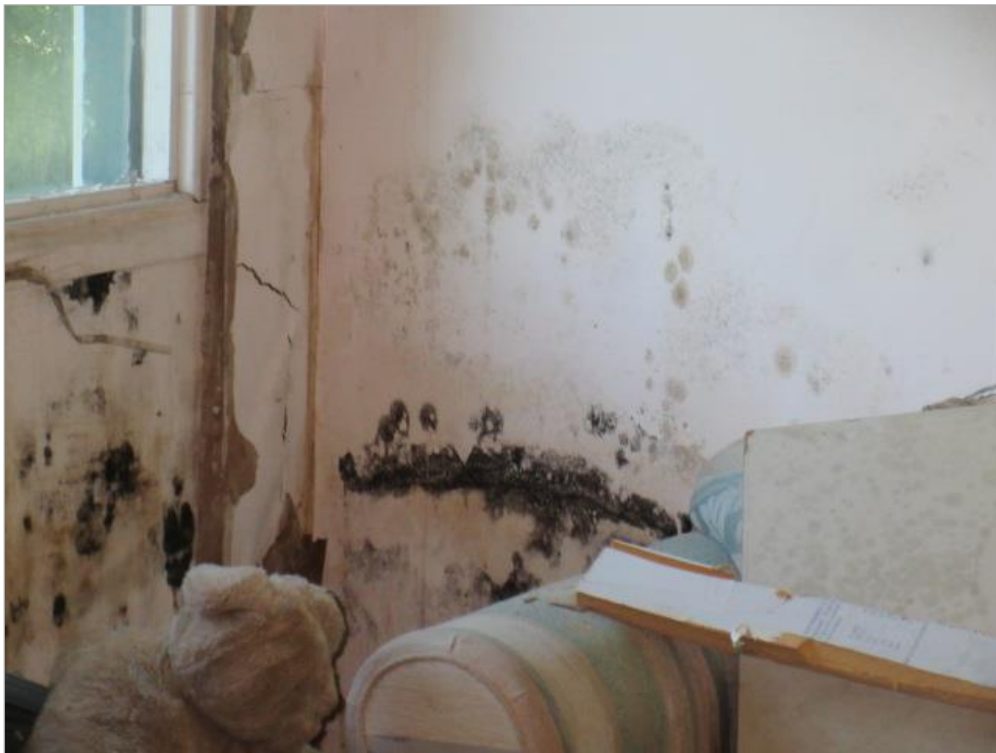
Moisissures sur le placoplâtre
