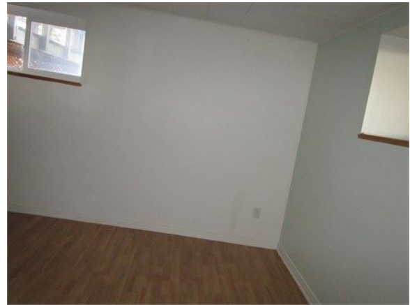
Le plancher de la salle familiale penche en partie vers la droite
