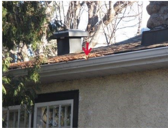
Nettoyer la gouttière arrière
