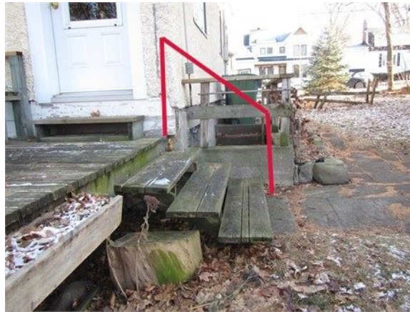
Ajouter une main courante dans l'escalier arrière
