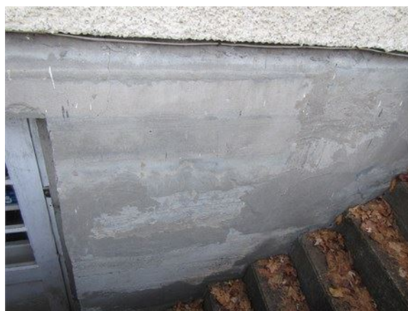
Mur latéral gauche recouvert de béton alors que dans le sous-sol le mur est en pierres
