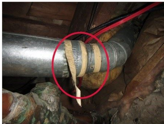
Exemple de joint de conduit d'air mal scellé
