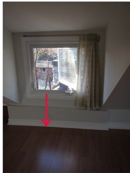
Exemple de fenêtre dont le seuil est bas à l'étage
