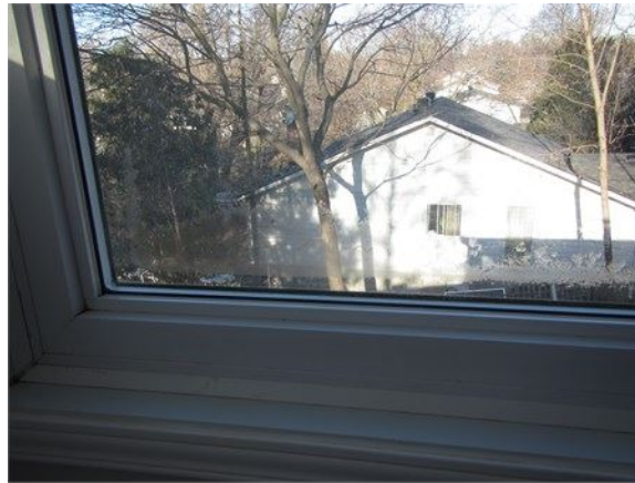
Exemple de double-vitrage descellé
