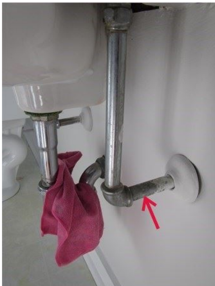
Exemple de conduite en acier galvanisé sous le lavabo à l'étage
