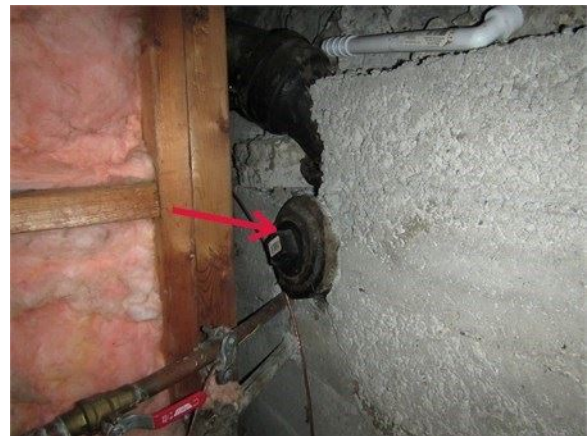
Le regard vers le collecteur principal plus haut sur le mur latéral gauche
