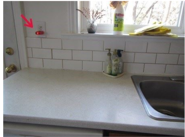
Prise près de l'évier sans mise à la terre : remplacer la prise par une prise DDFT près de l'évier en plus de réaliser la mise à la terre
