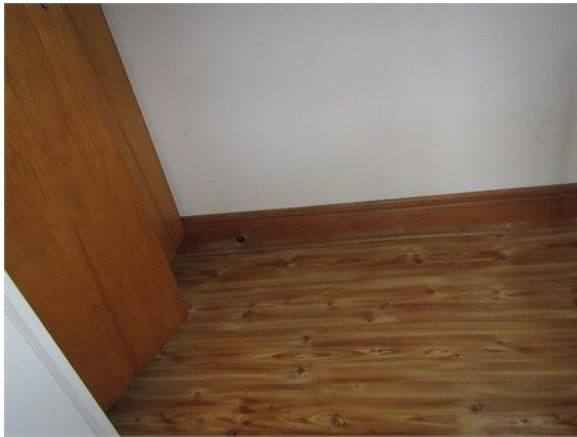
Le plancher de la cuisine penche vers l'avant, côté gauche
