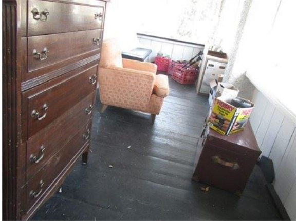
Le plancher de la véranda à l'avant penche vers l'avant, comme une galerie
