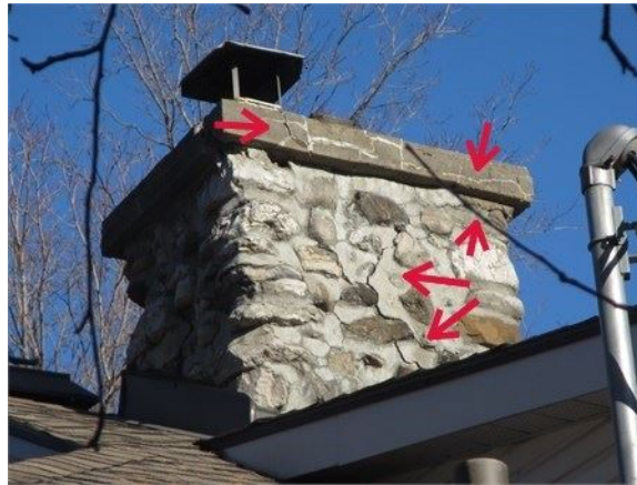
Fissures dans la maçonnerie et le couronnement à réparer
