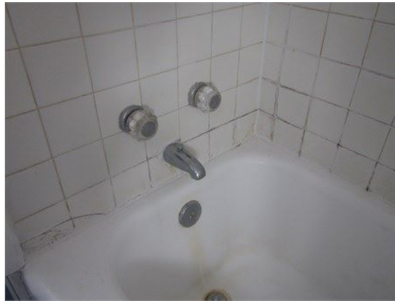
Carreaux de céramique à refaire autour de la baignoire du rez-de-chaussée
