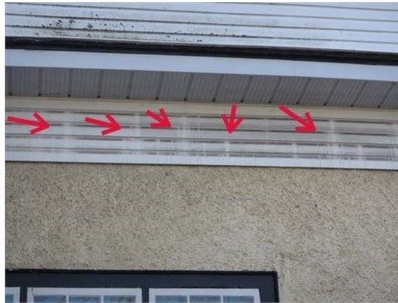
Traces d'écoulement sous la petite toiture et la jonction avec le mur de l'étage
