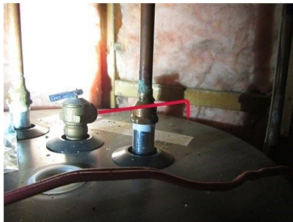
Installer une conduite d'évacuation sur la soupape de décharge du chauffe-eau
