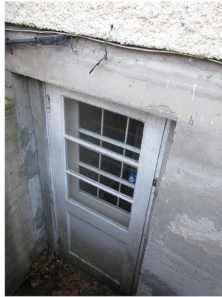
Porte d'entrée du sous-sol énérgivore
