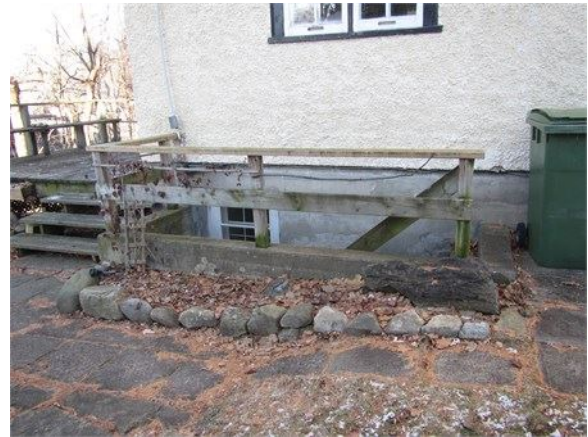
Garde-corps non conforme autour du puits de l'escalier d'accès au sous-sol
