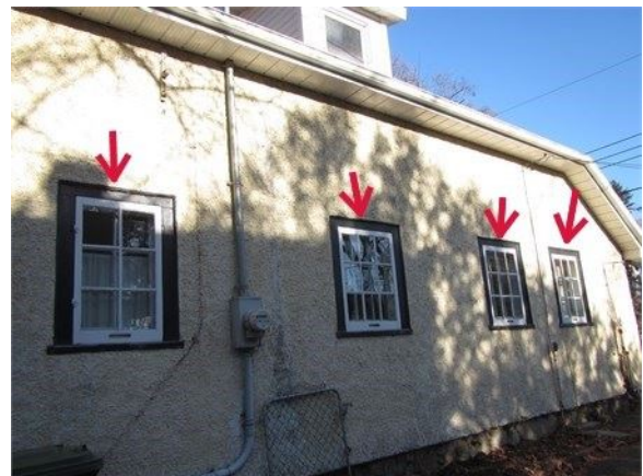
Absence de solins au-dessus des fenêtres du bâtiment
