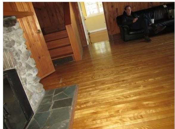
Le plancher du séjour penche vers la gauche
