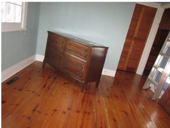
Le plancher de la salle à manger penche vers la droite
