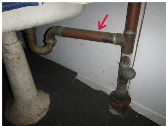
Exemple d'absence de clapet antiretour sur une conduite d'évacuation, ici la cuve de lavage
