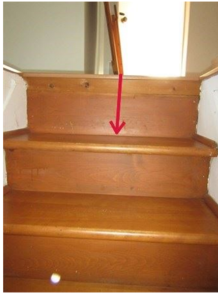
Contre-marche importante au haut de l'escalier de l'étage
