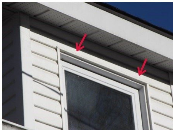
Absence de solin au-dessus d'une fenêtre dans le revêtement de vinyle d'une lucarne en guise d'exemple
