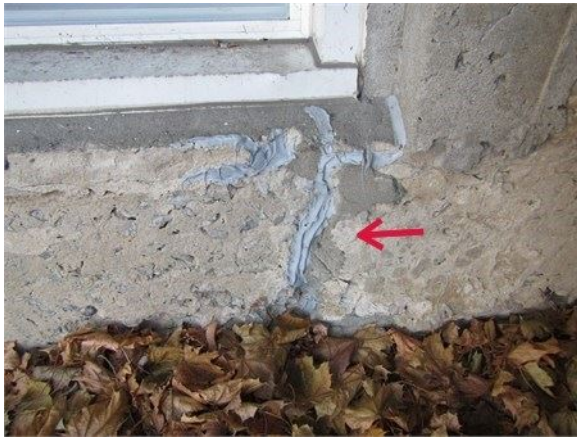
Fissure au coin inférieur gauche de la fenêtre du sous-sol sur le mur arrière
