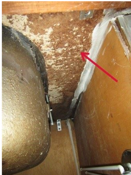
Détérioration importante de la sous-face du comptoir de la cuisine autour de l'évier : prévoir un remplacement
