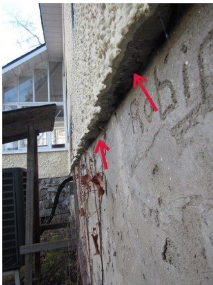
Exemple de revêtement de stuc collé au mur de fondation (ici le mur latéral droit)
