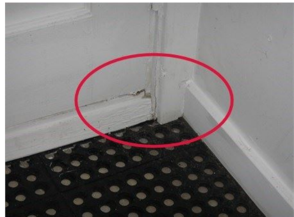
Traces d'infiltration d'eau du côté intérieur de la porte du sous-sol
