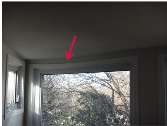
Affaissement au-dessus et devant la fenêtre la plus arrière du mur latéral droit de l'étage
