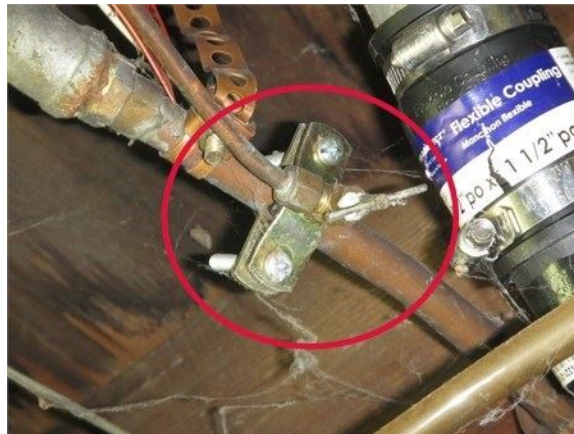
Robinet à sellette à remplacer pour éviter les fuites
