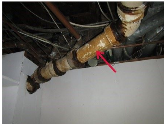
Vieux collecteur à surveiller au plafond du sous-sol
