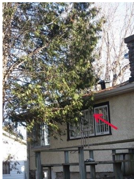
Couper les branches trop près du bâtiment
