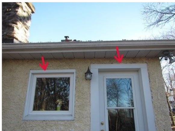
Absence de solins au-dessus de la porte arrière et de la fenêtre de la cuisine
