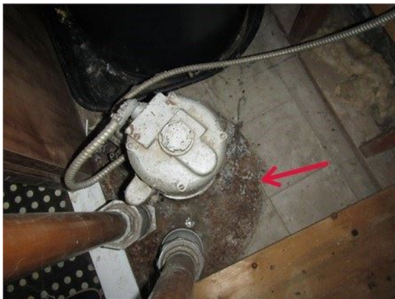
Le puisard scellé âgé au sous-sol
