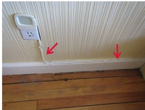
Câble à protéger à l'intérieur
