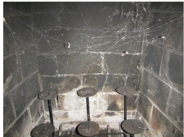
Des pierres dans l'âtre sont fissurées
