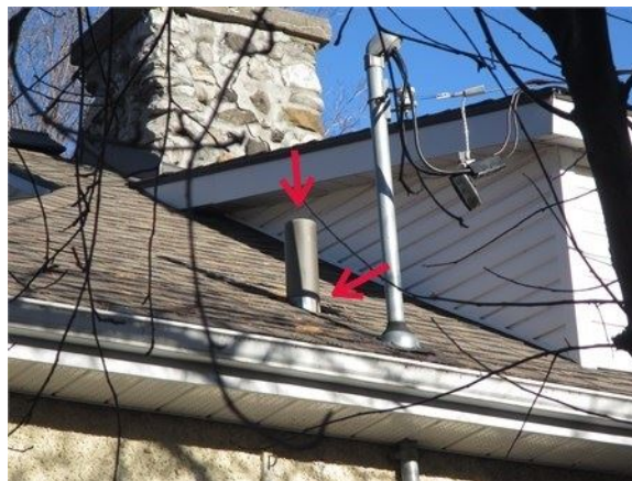
Le solin de l'évent de plomberie ne semble pas étanche : Vérifier l'installation et remplacer le solin au besoin
