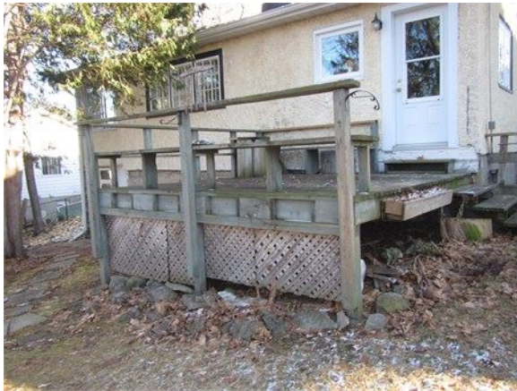
Garde-corps non conformes autour de la terrasse arrière
