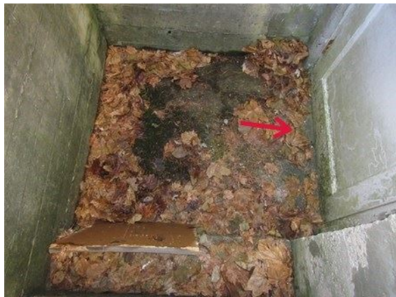
Seuil de porte trop près du palier inférieur de l'escalier extérieur
