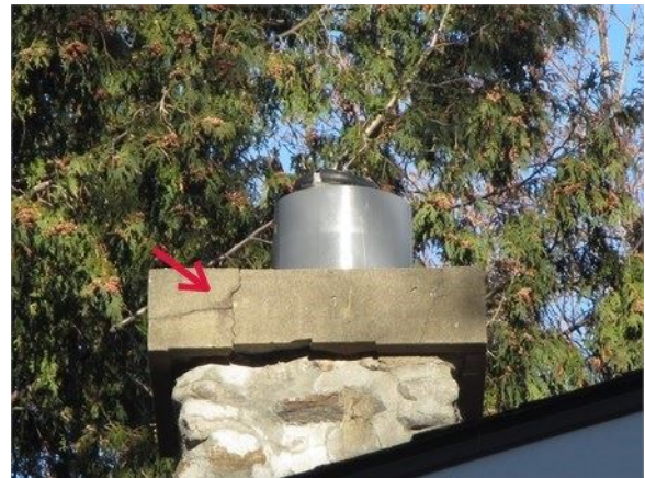
Couronnement fissuré sur la cheminée abandonnée
