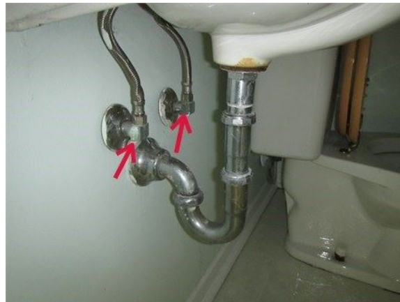
Absence d'anti-béliers sous un appareil
