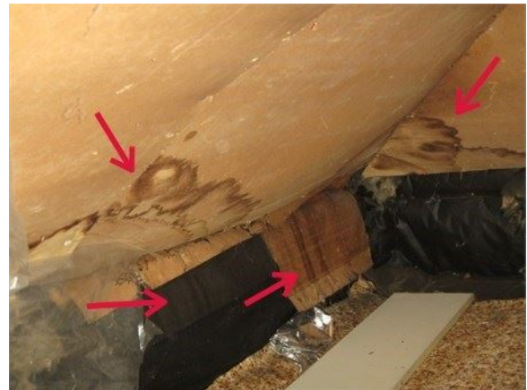
Traces d'eau sur le carton fibre sous la structure du toit, entretoit avant
