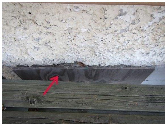
Contreplaqué sur le mur arrière à enlever pour vérifier l'état du mur de fondation
