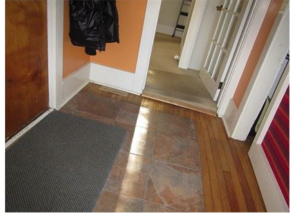
Le plancher du portique d'entrée penche vers l'arrière
