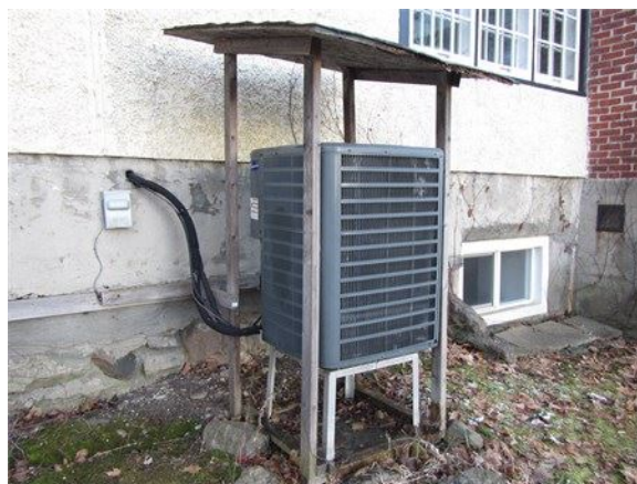
La thermopompe sur le mur latéral droit
