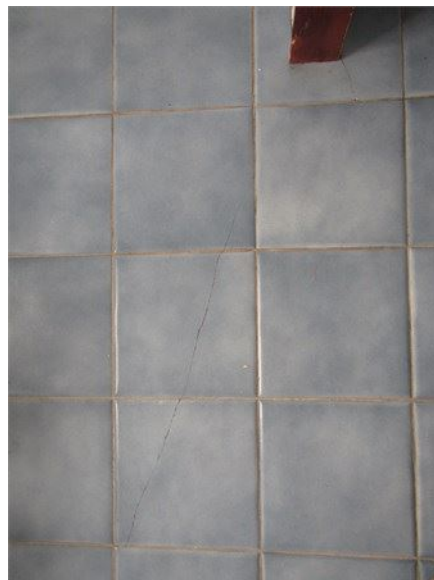
Carreaux fissurés dans la salle de bains du rez-de-chaussée
