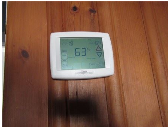
Le thermostat central au rez-de-chaussée
