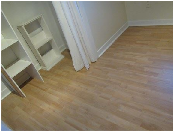
Le plancher de la chambre avant droite penche vers l'arrière gauche
