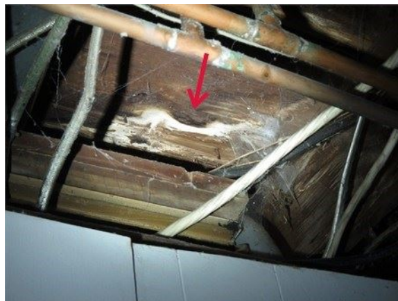
Champignons probables dans la structure du plancher du rez-de-chaussée à nettoyer
