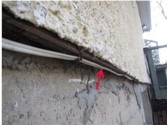
Câble à protéger à l'extérieur sur le mur arrière
