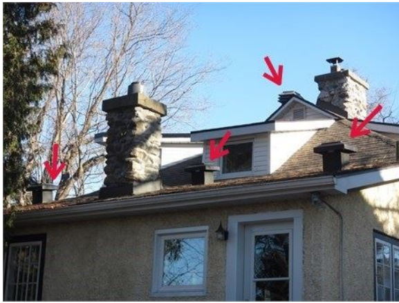
Trois aérateurs dans la pente arrière et un aérateur de toit à droite de la cheminée principale
