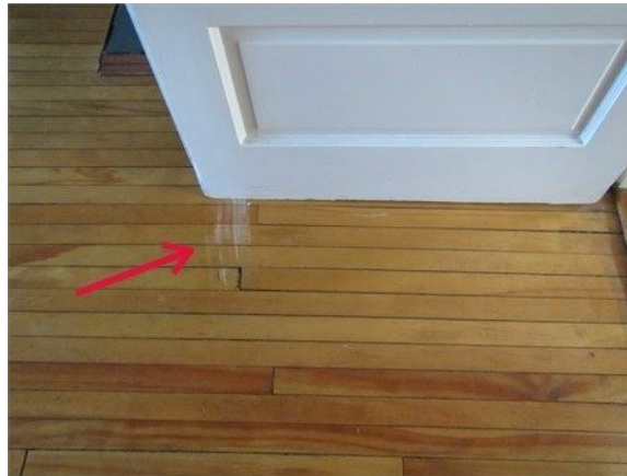
La porte frotte contre le sol
