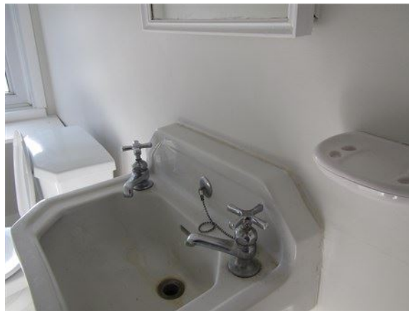
Absence de prise près du lavabo à l'étage
