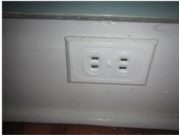
Prise ancienne sans mise à la terre
