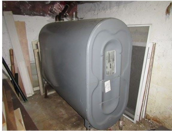
Le réservoir de mazout au sous-sol
