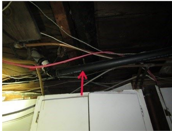
Pente négative d'une conduite au plafond du sous-sol
