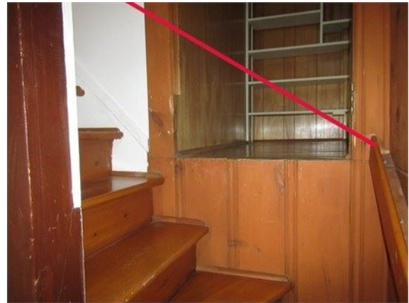
Installer une main courante dans les sections où elle est manquante dans l'escalier de l'étage
