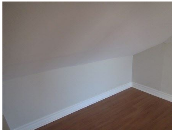
Finis irréguliers probablement liés à une faiblesse structurale du toit
