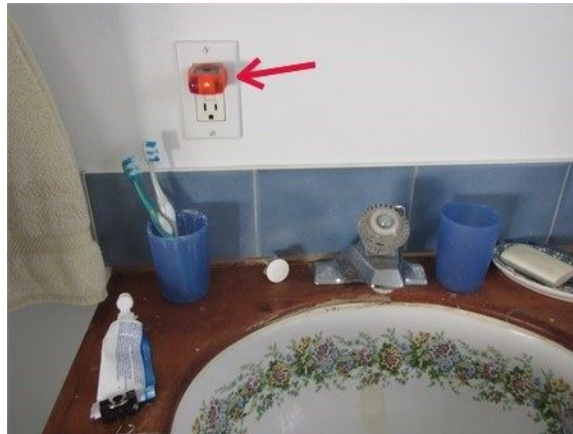
Prise sans mise à la terre à corriger au rez-de-chaussée
