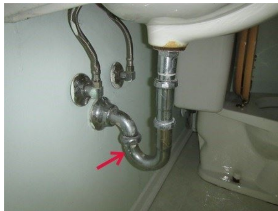
Siphon qui commence à percer sous le lavabo de l'étage
