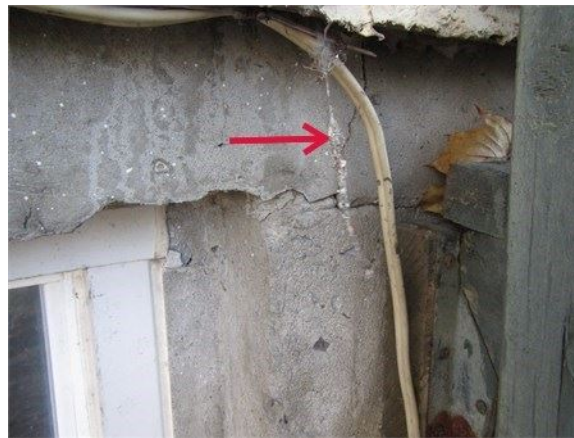
Fissure au coin supérieur gauche de la fenêtre du sous-sol sur le mur arrière / Noter la réparation du béton en partie supérieure
