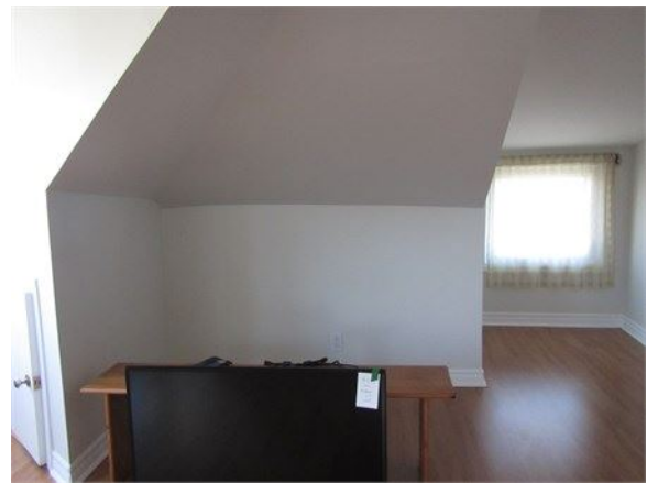
Finis irréguliers probablement liés à une faiblesse structurale du toit
