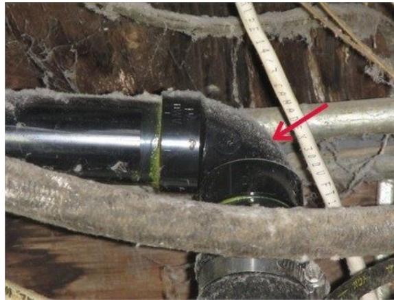
Coude à court rayon dans le sous-sol
