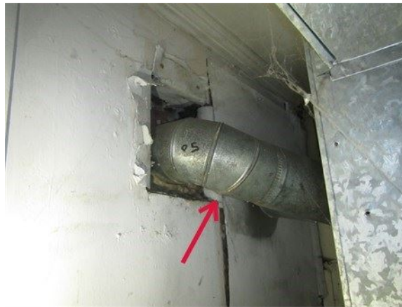
Le conduit de fumée à l'entrée de la cheminée au sous-sol
