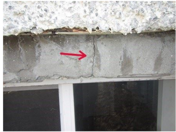
Fissure au-dessus de la fenêtre du mur arrière du sous-sol
